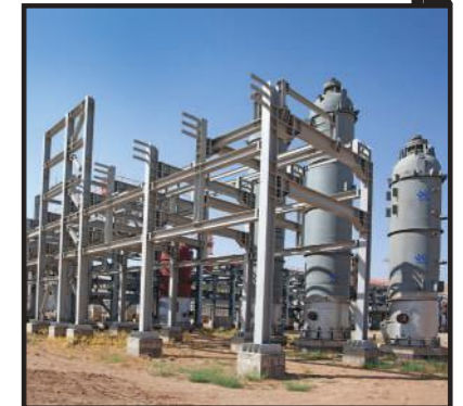
سازه‌های فلزی واحد آمونیاک صنایع پتروشیمی کرمانشاه
